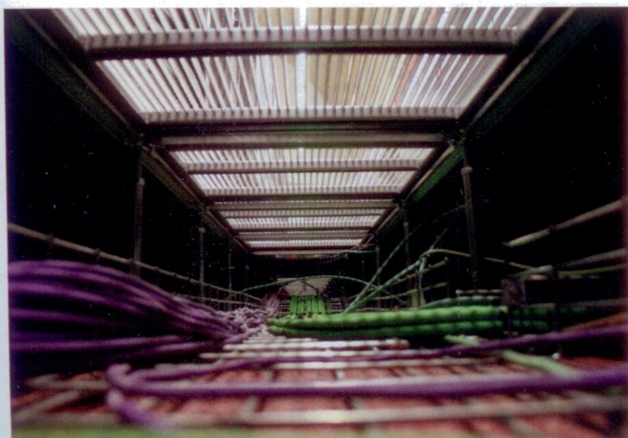
Cableado de Lusitania bajo el suelo.
